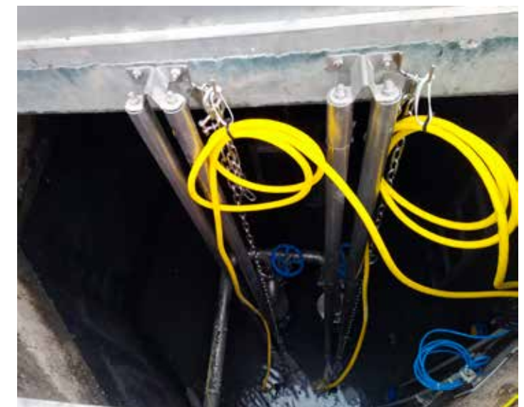
přečerpávací stanice v objektu ZOD Zálabí
