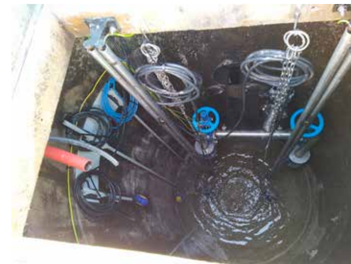
přečerpávací stanice v ulici Na Ohrádkách
